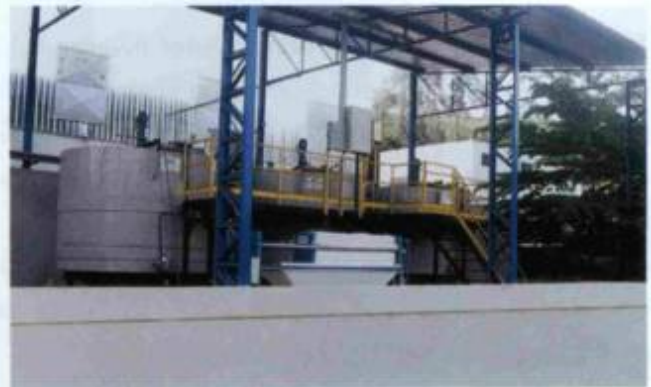
Estação para tratamento de efluentes
