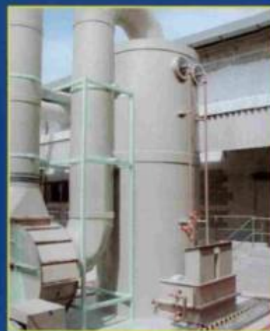
Lavadores de gases
