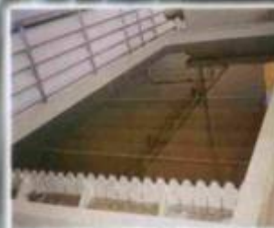
Clarificador lamelar contínuo em polipropileno
